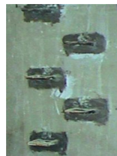
Fot. 1. Uszczelnienie Hydrostopem-Superelastycznym 2kg/m 2 styku powłoki penetrującej z metalowym osprzętem zbiornika przeciwpożarowego – widoczne klamry żelienne w ścianie pod włazem zbiornika.
