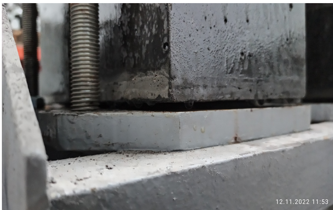
Fot. 1. b. Próbka kontrolna K1 przy ciśnieniu wody 0,2 MPa. Widoczne krople wody na dolnej krawędzi będącej jednocześnie krawędzią warstwy zaprawy.
